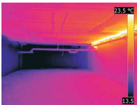
Infraroodfoto van een kruipruimte met geïsoleerde CV-buizen. De buisisolatie straalt veel warmte uit waardoor onder andere de bovenkant van de fundering onnodig wordt opgewarmd.
